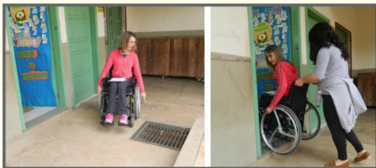
Figura 11 – Acesso à sala de aula: obstáculos
