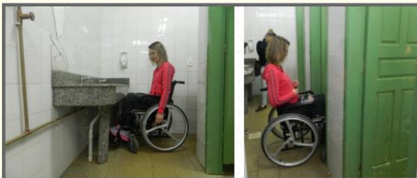
Figura 10 – Interior dos sanitários: falta de equipamentos e espaços adequados
