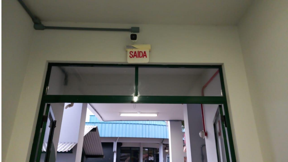
Figura 31 - Identificação de saída de emergência
