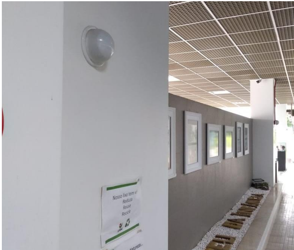
Figura 32 - Luz de emergência
