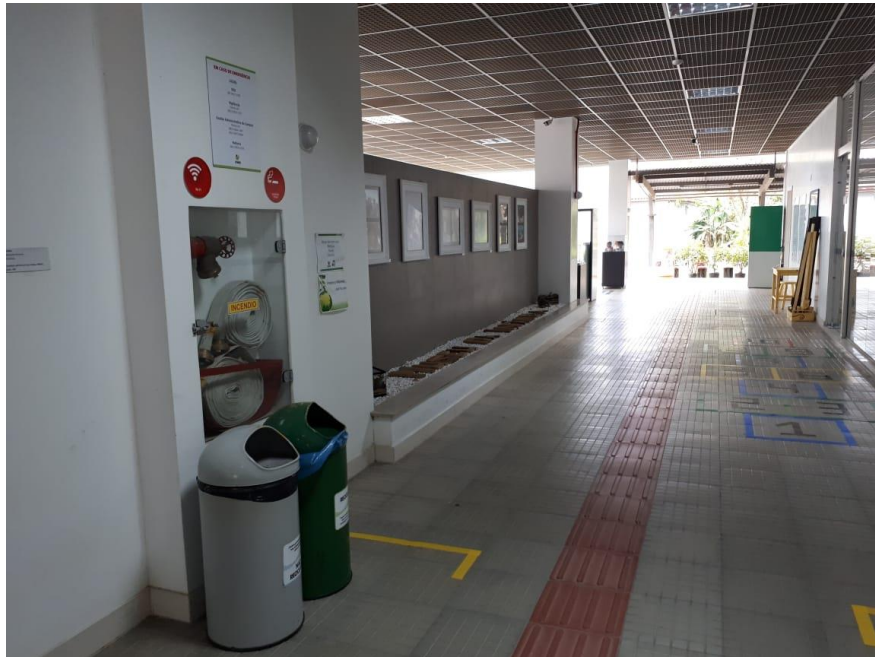
Figura 33 - Mangueiras contra incêndio
